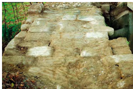
Figura 8. Tabuleiro da Ponte da Veiga (1996), onde é perceptível a ausência das aduelas do arco montante (à esquerda no tabuleiro) (Serenho e Amaral, 1996).
