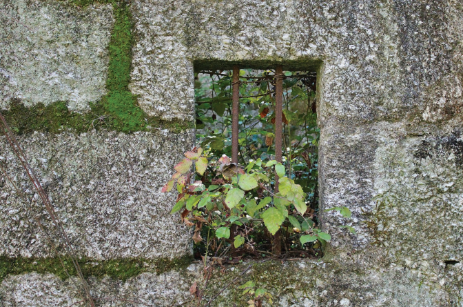
FIGURA 27. Postigo sem cerramento de vão (Moinho de Pontarrinhas 3, n.º 119).
