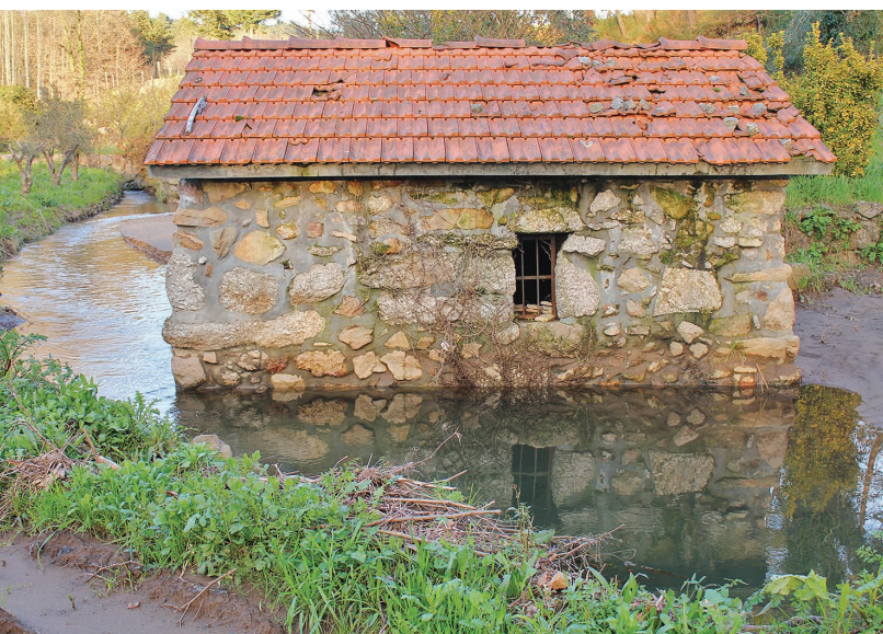
FIGURA 12. Moinho da Quinta das Lajes (n.º 165) parcialmente submergido, na sequência de uma cheia no ribeiro de Barrosas (São Miguel).
